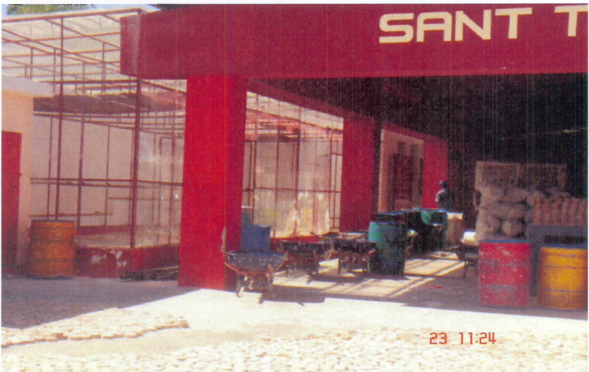
Espace de séchage des briquettes en fibreglass
